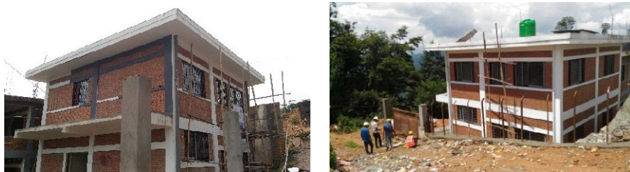
図 2.5.10 女性交流訓練センターの再建を通じた地方部における女性の社会参加支援プロジェクト（QIP-2）工事状況
