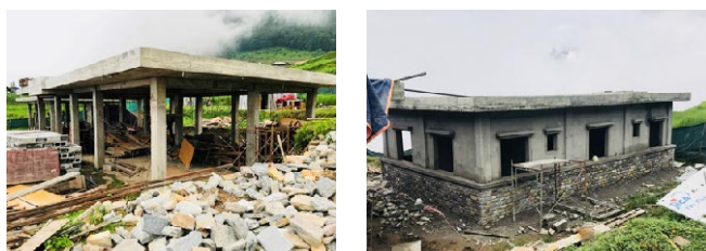
図 2.5.48 ヘルスポストの再建を通じた保健衛生サービスの強化支援プロジェクト (QIP-14) 工事状況
