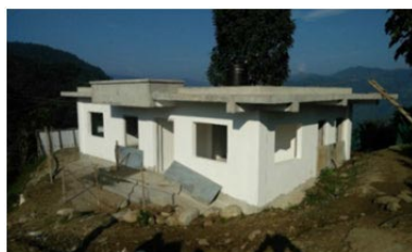
図 2.5.51 Saurpani 村開発委員会事務所の再建を通じた社会サービス向上支援プロジェクト（QIP-16）工事状況
