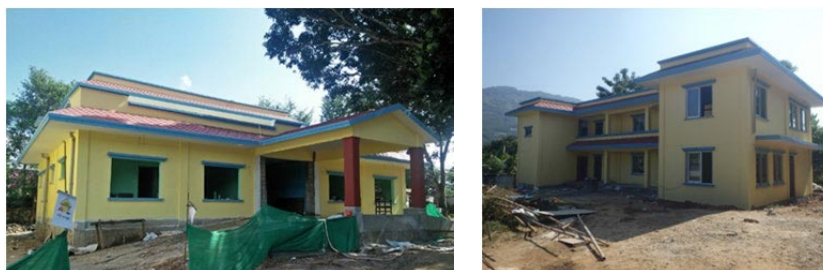
図 2.5.18 Palungtar 地域警察署 (PAPO) の再建を通じた治安維持、社会サービス向上プロジェクト (QIP-4) 工事状況
