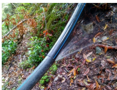
接合部からの漏水
