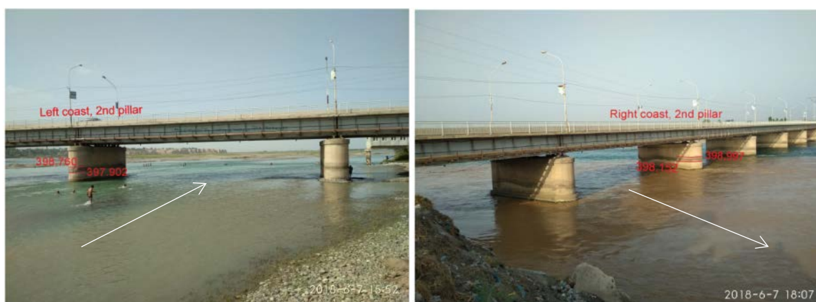
図 3.2-42 バフシュ川橋梁の水位痕跡
