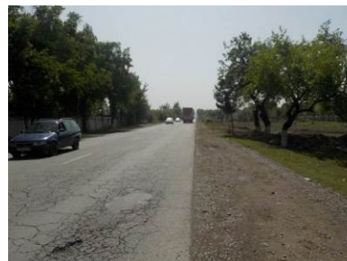
写真 3.2-5 ポットホール
