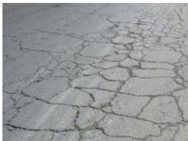
写真 3.2-4 局所的な舗装の亀甲ひび割れ
