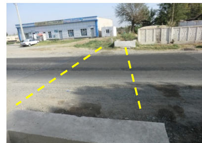
写真 3.2-6 集水柵周辺の漏水
