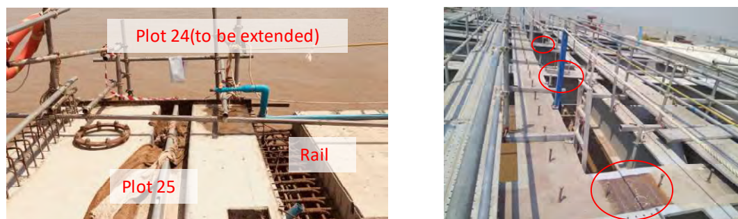
a) Plot24 へ延伸することを前提に施工されたクレーンレール溝 b) 上部工の桁間の H 鋼の溶接による剛結合 (断面方向に 11 か所)
