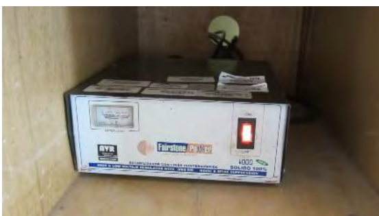
写真-15：電圧安定装置。停電は少ないものの、電圧が不安定なので対策が望ましい。
