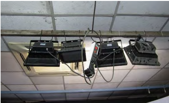
写真-5 : スタジオ照明。屋外用一般投光器を流用しており光量調整が出来ない。
