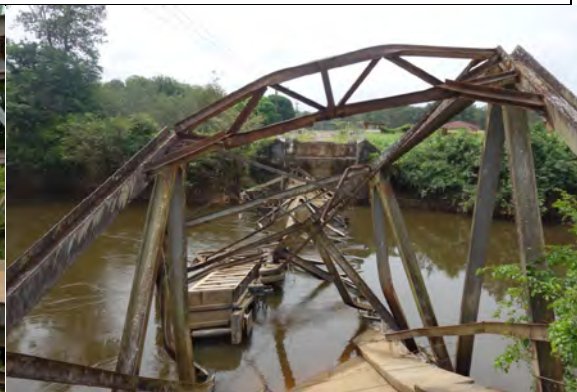
Du River 橋 落橋
