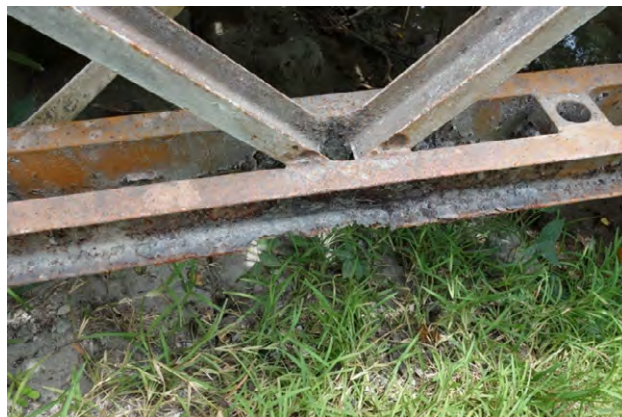
鋼材の腐食状況
