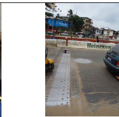
ジョイント破損状況
