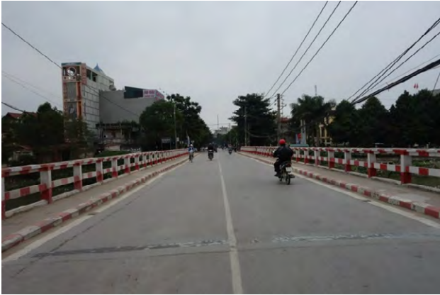
橋梁（タインホア省）でのカーボンファイバーでの補強橋梁全景
