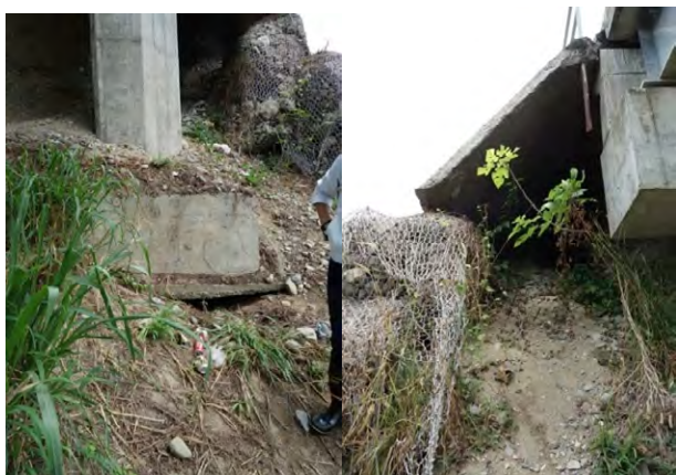
Poha 橋 基礎の洗掘 保護蛇籠の流出
