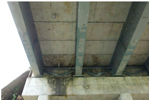
橋台・桁の接続部 (排水口の破損による濡れ)
