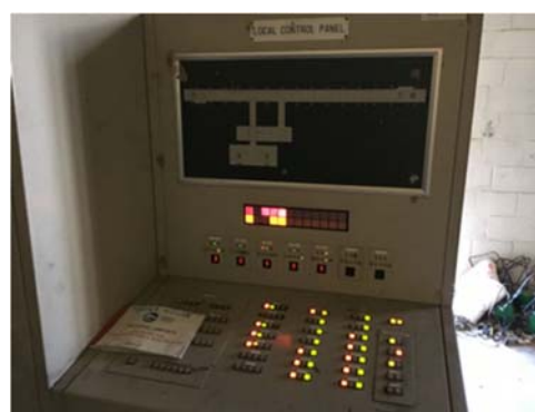
写真 24 地上階機械室にある航空灯火制御盤
