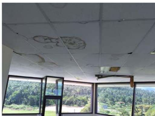
写真 17 管制室の雨漏り跡
