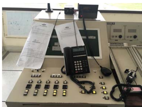
写真 23 故障している航空灯火制御盤
