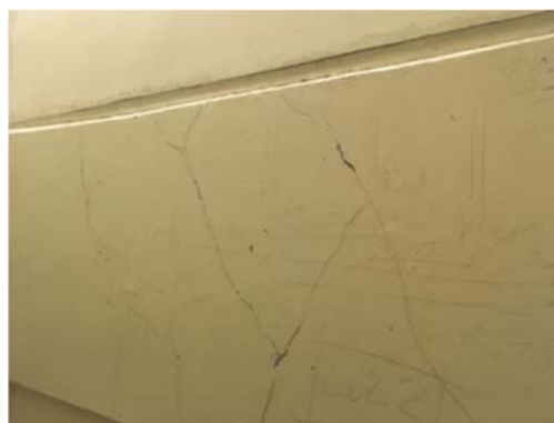
写真 18 管制塔梁のクラック
