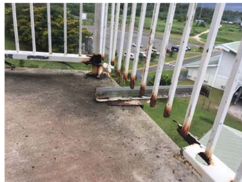
写真 16 管制塔犬走りの劣化し手摺
