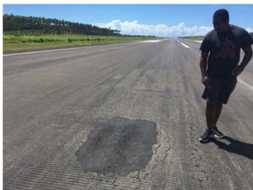
写真7 滑走路舗装の補修状況(1)
