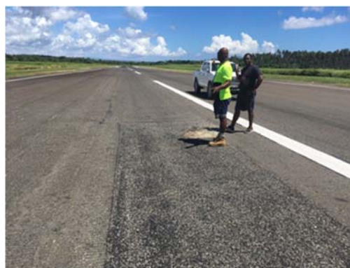
写真8 滑走路舗装の補修状況(2)
