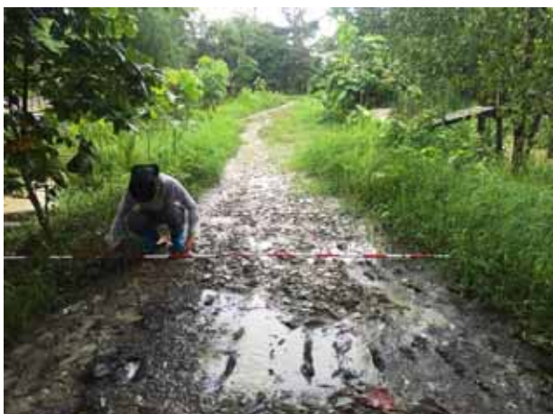
[道路・橋梁 1、サバイコン村落] 碎石舗装されている現道。損傷程度が大きいいため、通年通行は困難である。デルタ地帯であり、軟弱粘土層が30m以上堆積。支持層は確認できない。
