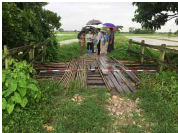
[道路・橋梁 2、シッサリトン村落] 既設橋。木製床版の鋼鈹桁橋である。損傷が大きいこと、桁の耐力が不足することから、車両の通行は困難である。
