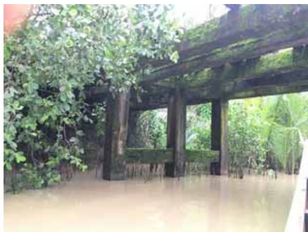
[道路・橋梁 2、サバイコン村落] 村と幹線道路を結ぶ道路上の橋梁。床版の損傷が激しく、車両の通行は困難である。下部工はラーメン式橋脚である。
