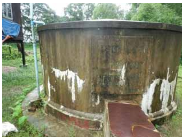
[給水1、シッサリトン村落] UNDPが建設した雨水貯留施設。
