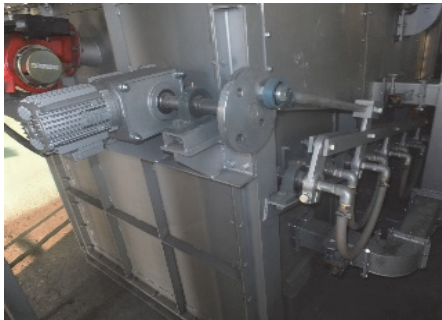
MUHT-3 ボイラ燃焼炉
