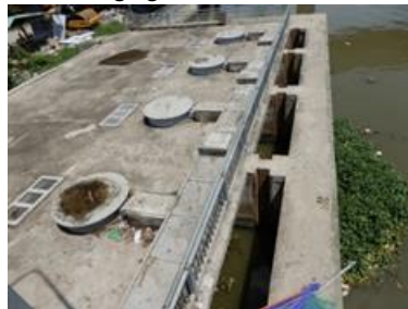
Máy bơm lắp đặt bên bờ phải
