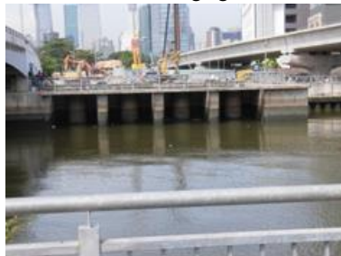
Đầu vào máy bơm bên bờ phải
