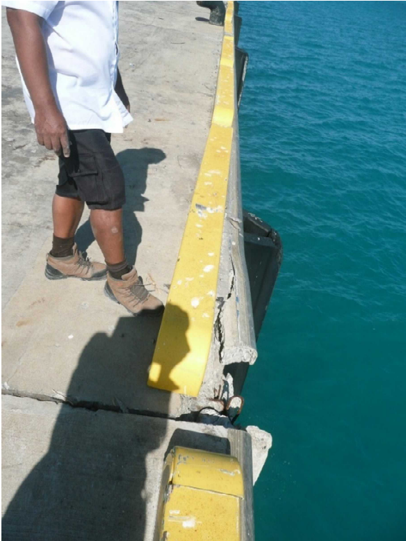
車止め及びコーナープレーットの損傷
