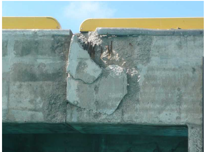
上部工端部の剥離（キー箇所、鉄筋露出）
