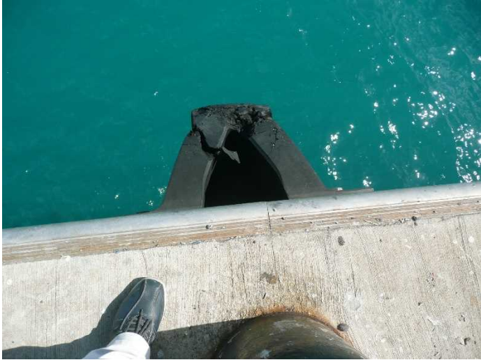
ゴム防舷材の損傷・劣化
