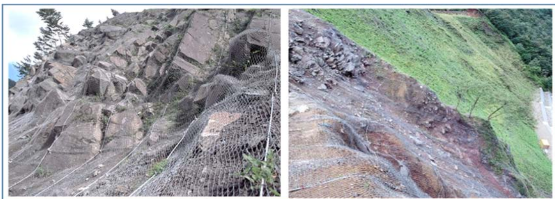
図 2-9: 密着型落石防止網工(落石防止工)
