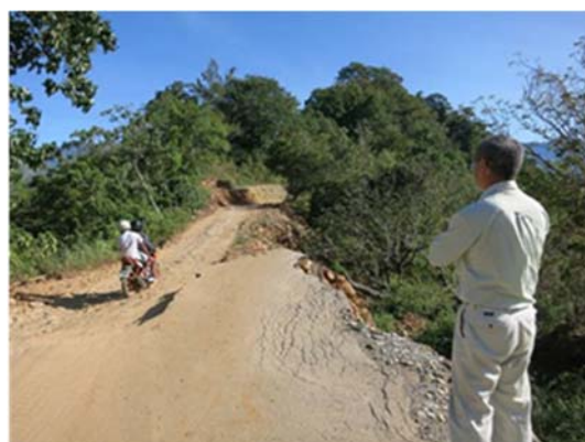
国道2号線:昨年に大規模な土砂崩れがあった箇所
