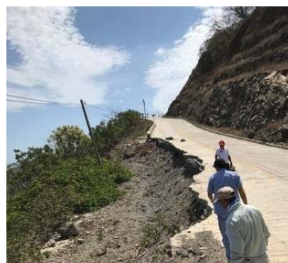
図 1: 国道 3 号線カリンバラ地区雨期の落石による路盤陥没事故現場
