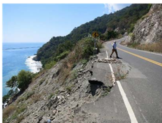
国道3号線:落石による土砂崩れ箇所
