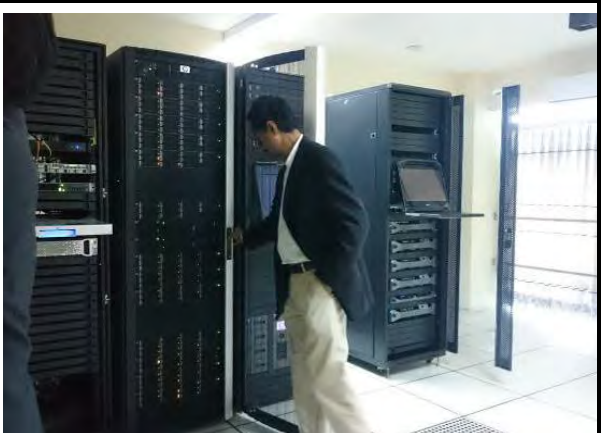
写真-6 プロジェクトサイト 「電子基準点管理システム」が設置されるSOB ミルプール庁舎内のサーバー室は、空調設備や電源等を備えている。
