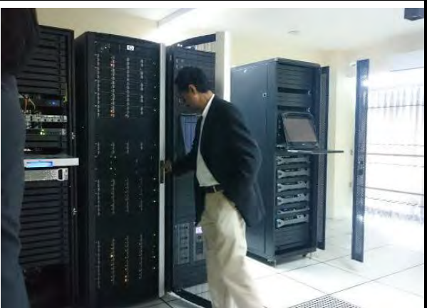
写真-6 プロジェクトサイト 「電子基準点管理システム」が設置されるSOBミルプール庁舎内のサーバー室は、空調設備や電源等を備えている。
