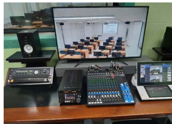
eラーニング教室の制御盤
