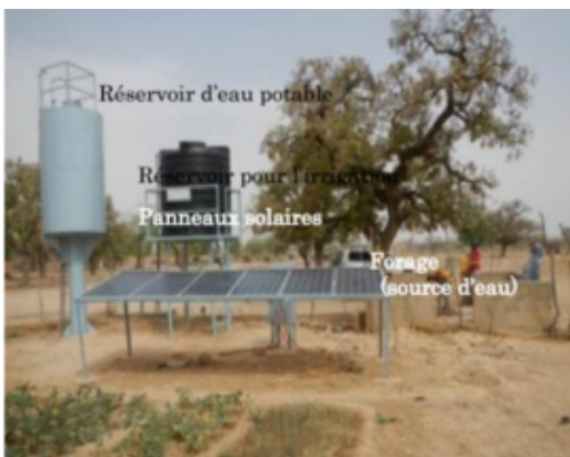
Système de pompages par énergie solaire photovoltaïque mis en place dans la présente étude
