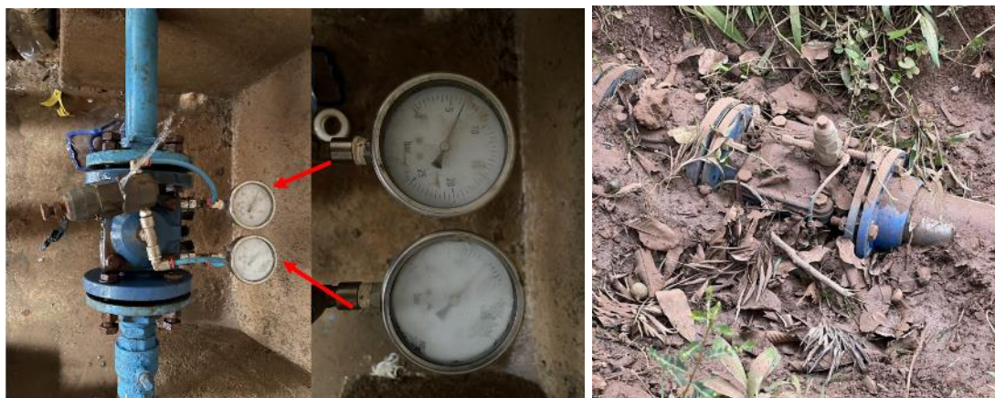
写真 2.2-1 既存減圧弁の状況
