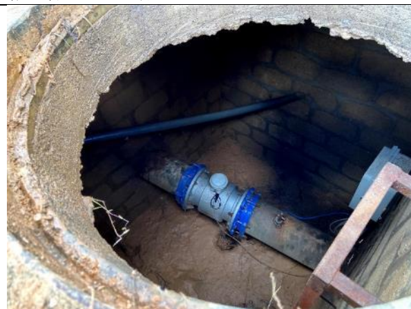
故障した既存の流量計
