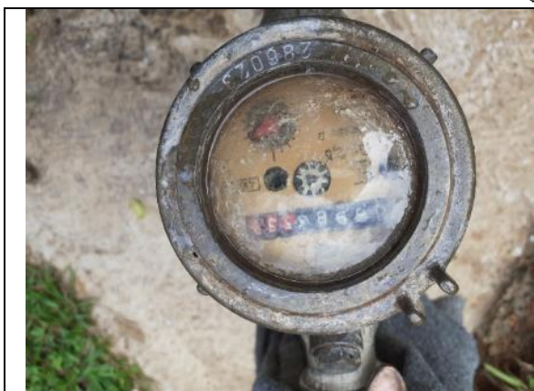
流量が読み難くなっている顧客メーター
