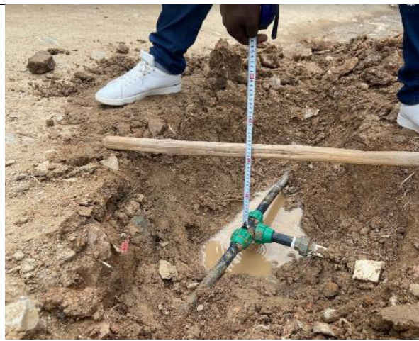
質の悪い施工の例（浅すぎる埋設）
