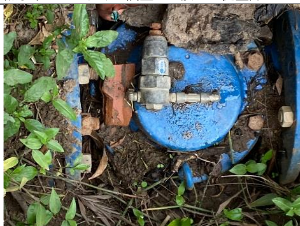
直接埋設され確認が困難となっている既存減圧弁
