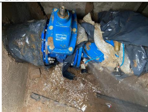
既存減圧弁からの漏水の様子
