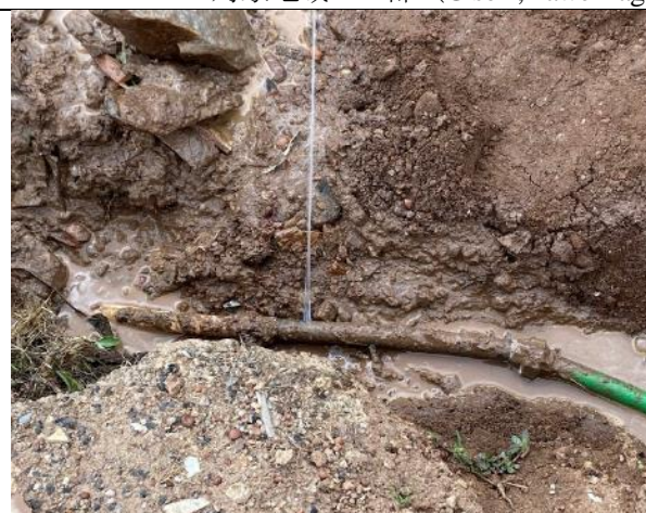
給水管の漏水の様子
