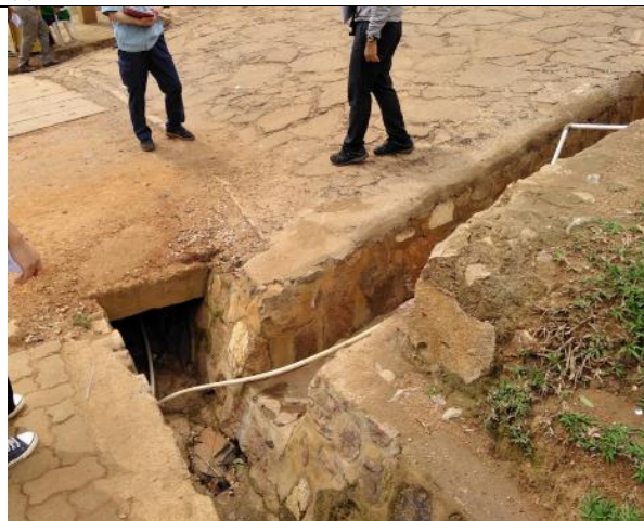
排水側溝に保護なしで直接配管された給水管
