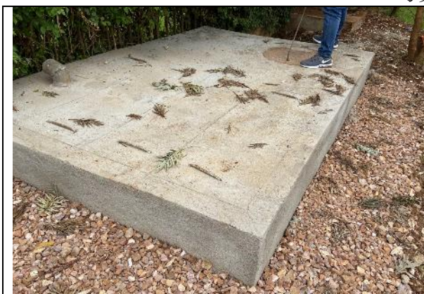
無取水ベースライン調査で建設した流量計室
