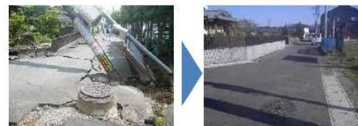
地盤の液状化による下水管の被害と復旧後 （熊本県益城町）
