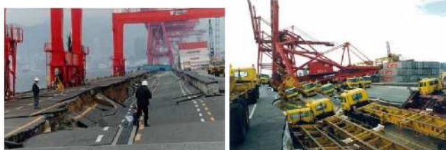
○東日本大震災における耐震強化岸壁と一般岸壁の被災状況(小名浜港の例)
