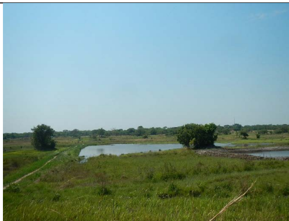
ため池全景 試験ほ場の水源ため池（堤高 2.8 m、堤頂長 160 m） 技プロ(RDP)により 2018 年、貯水池の修復とサイホンによる取水工の新設が行われた。
