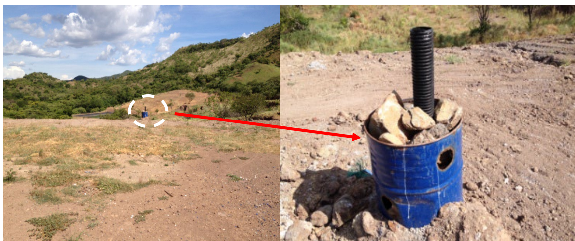
Foto 3 Relleno sanitario semiaeróbico en Santa Rosa de Lima, El Salvador.
