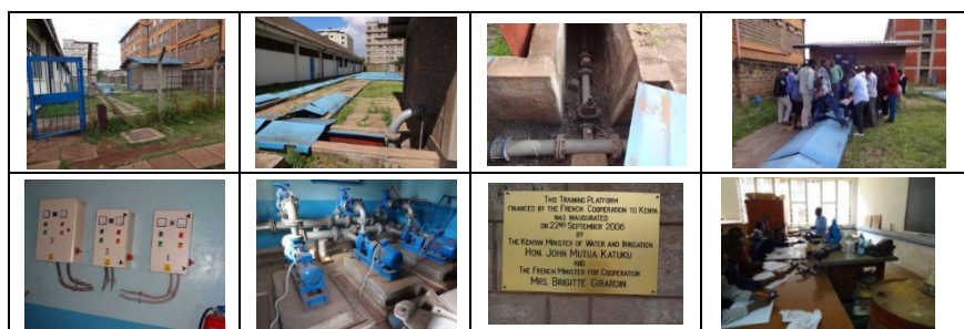
写真 3-1 配水管網実習場の設備と研修風景
