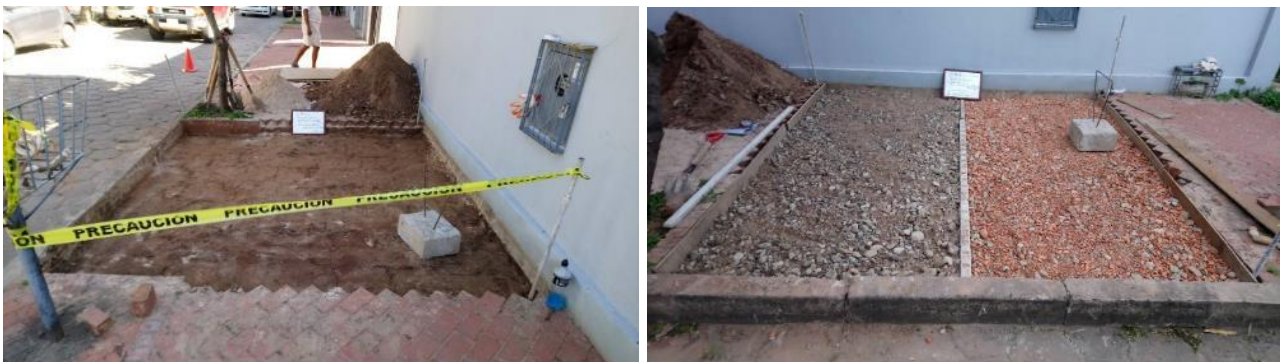
図9 試験施工状況1（碎石路盤（左）およびレンガ廃材ブレンド路盤作成（右））
