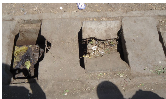
写真 2.8 重量車両により破壊された側溝蓋
