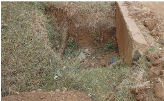
写真 2.6 土砂で埋まった横断管
