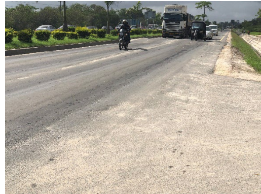
ハンプ前後の舗装破損事例
