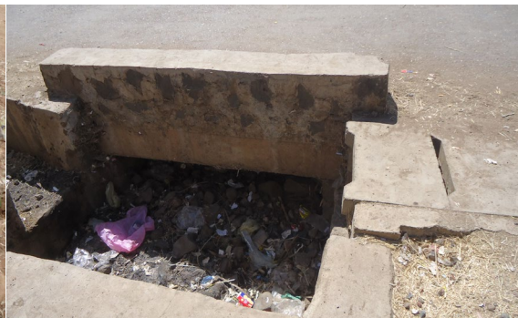
写真 2.7 ゴミ捨て場と化した横断函渠
