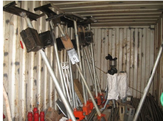
写真 16: ムベンデ県サービスセンターによるス ペアパーツ供給体制整備 (2018/11-2022/6)
