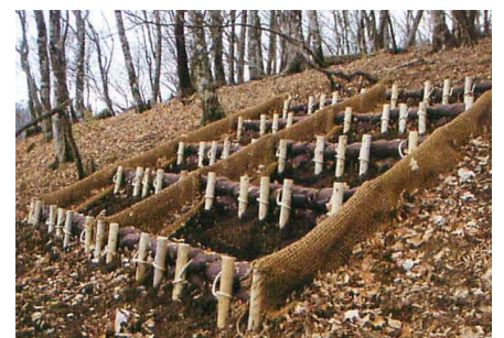
土のう工による落ち葉の捕捉
