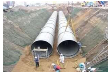
右岸幹線用水路 (強化°ラスタック複合管: 口径2,800mm×2条)
