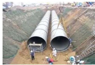
کانال آبی ساحل راست لوله فایبرگلاس (GRP-Glass Reinforced Plastic): قطر: 2800 میلیمتر در دو ردیف
