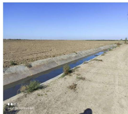
کانال آبی بتنی (سبز دشت قلعه‌ها)
