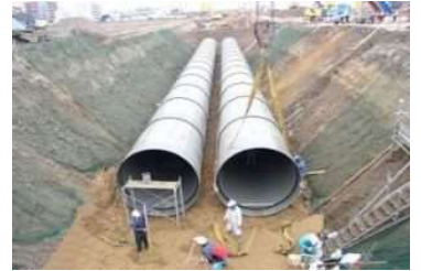
右岸幹線用水路 (強化°ラスタック複合管：口径2,800mm×2条)
