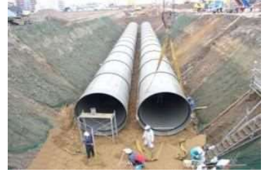
کانال آبی ساحل راست لوله فایبرگلاس (GRP-Glass Reinforced Plastic): قطر: 2800 میلیمتر در دو ردیف
