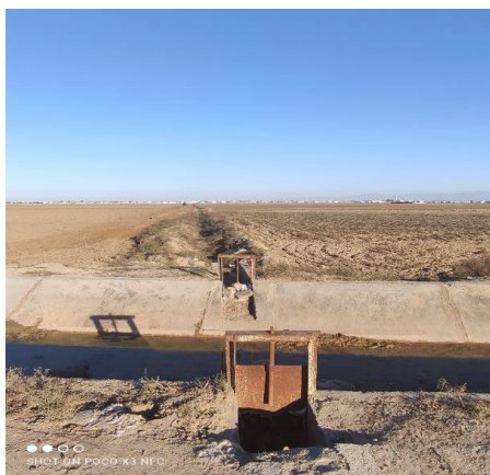
支線水路への分水ゲート (Parto Banavor 地区)
