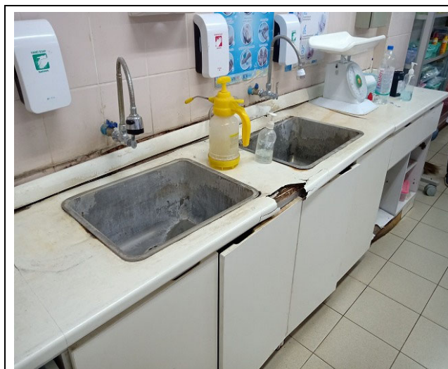
シンク付きカウンターは清掃不足のため水による損傷が顕著であった。(コンポンチャム州病院)
