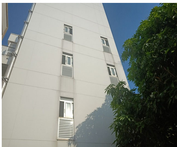
窓下部のガラスブロックが割れて危険なためガラリに取り換えていた。(国立母子保健センター)
