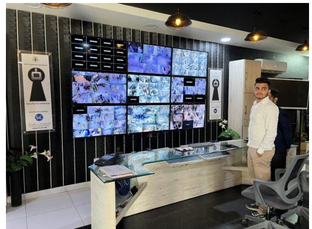
病院内のセキュリティは民間事業者へ外部委託。 監視カメラ及びガードマンの配置をしている。
