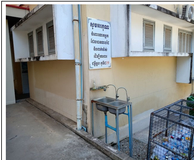
建物の入口付近には簡易的な手洗器を設置
