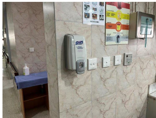
建物内に追加設置された消毒液ディスペンサー
