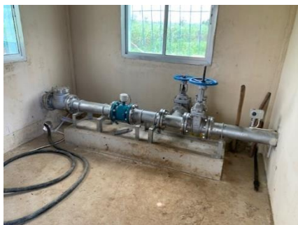
ポンプ室内配管及び流量計（新設井戸）
