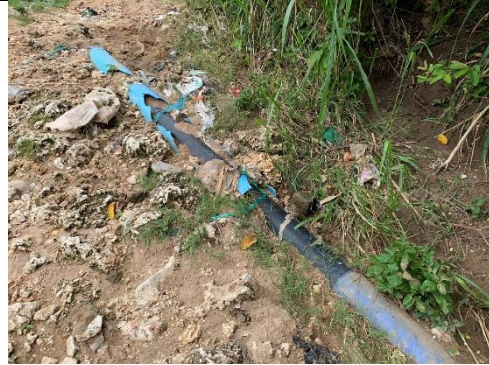
巻頭写真 4 土被りの浅い導水管路 管路が地表にむき出しになっている。今のところ本管に損傷はないが、管路寿命が短くなる懸念される。
