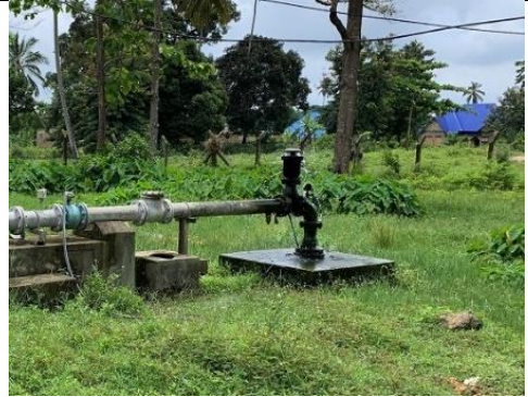
巻頭写真 5 更生工事が実施された井戸 稼働しているが、空気弁のところから漏水が発生している。修理は行われていない。
