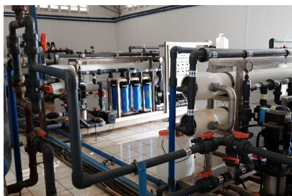
写真 2.4 逆浸透膜 (RO) フィルター
