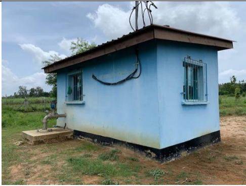
巻頭写真 1 ZUWSP で建設された新規井戸水源 上屋が建設されているが、井戸は上屋の外にあり保護されていない。
