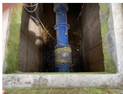
ムナラワンバオ配水池流入流量計
