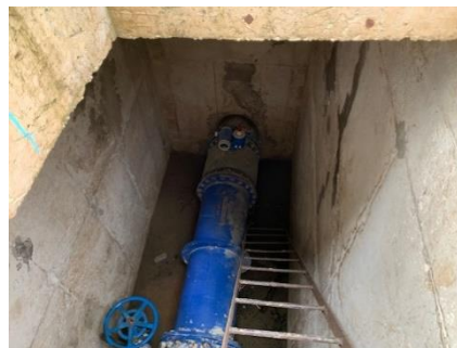
サティニーニ配水池配水流量計
