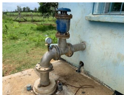
井戸上部の圧力計及び空気弁（新設井戸）
