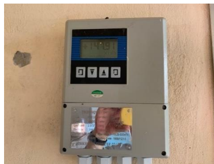
電磁流量計表示器（新設井戸）
