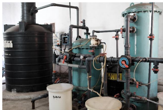
写真 2.7 逆浸透膜 (RO) フィルター
