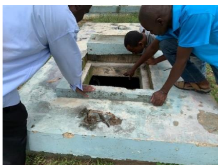
ムナラワンバオ配水池流量室
