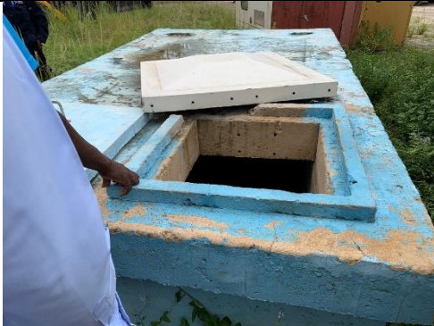
巻頭写真 7 配水池に設置された流量計室外観 サティニー配水池に導入された流量計室
