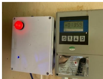
電磁流量計表示器（更生井戸）
