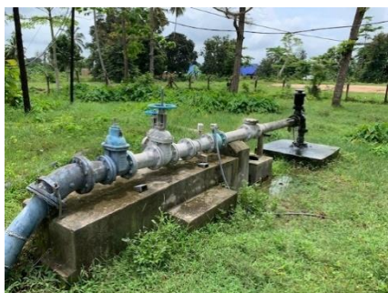
井戸及び井戸回り配管と空気弁部の漏水（更生井戸）
