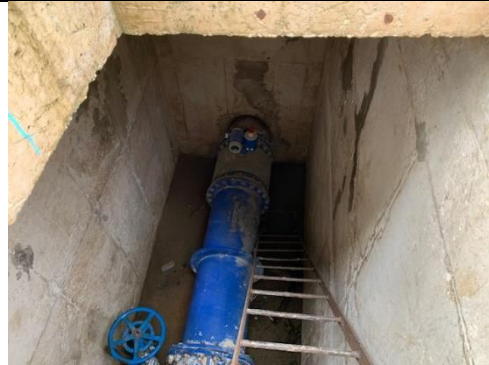
巻頭写真 8 配水池に設置された電磁流量計 サティニー配水池に導入された電磁流量計。稼働していない。ケーブル類の接続が確認出来ない。
