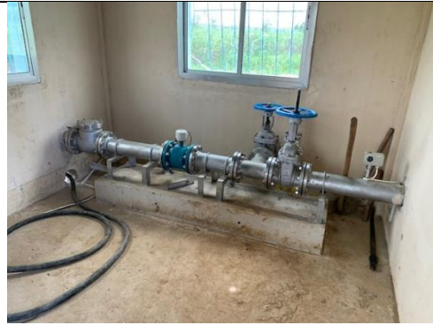
巻頭写真 2 同左井戸水源の上屋内部の配管 これまでは羽根車式流量計が採用されていたが、電磁流量計が導入された。
