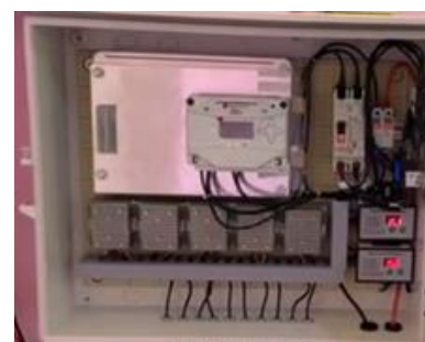
ベナンの学校充電システムで使用中のマンガン酸リチウムバッテリー
