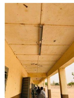
廊下の照明 (非稼働)
