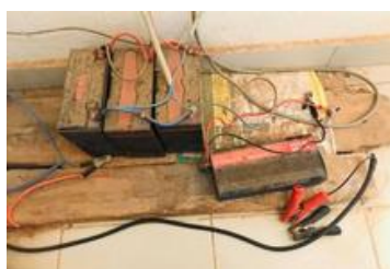
教室棟のバッテリー (故障)
