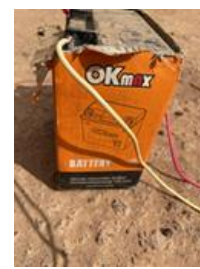
故障したバッテリー
