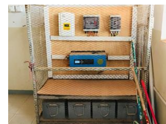
太陽光発電システムのコントローラ
