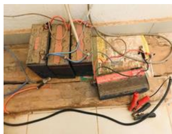
近接校の稼働していない バッテリー
