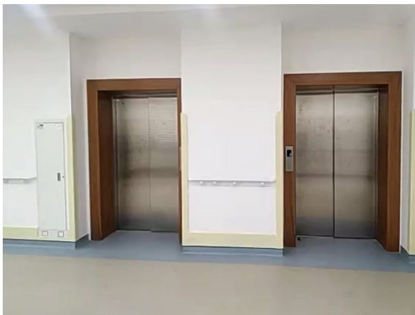
エレベーター
