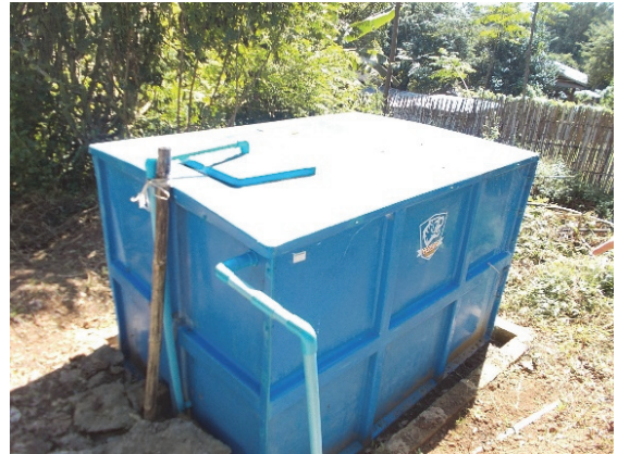
プロジェクトにより設置された給水施設の水タンク（ナーポット村）
