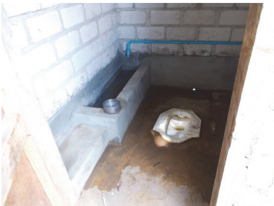
水洗トイレ（ナーポット村：給水施設建設に合わせて自発的に家庭内に建設された事例）
