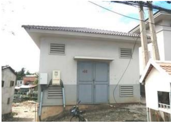
配電用変電所 D005AD005 出所：調査団
