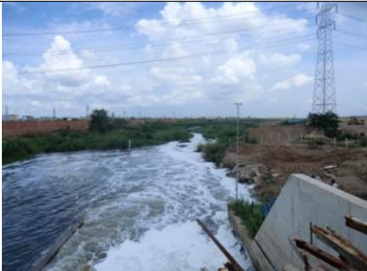
Trabek ポンプ場吐出口
