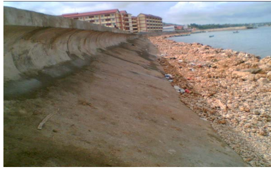
図 4-85 コンクリートブロック積護岸工 Pantai Banding BBWS Mesuji Sekampung
