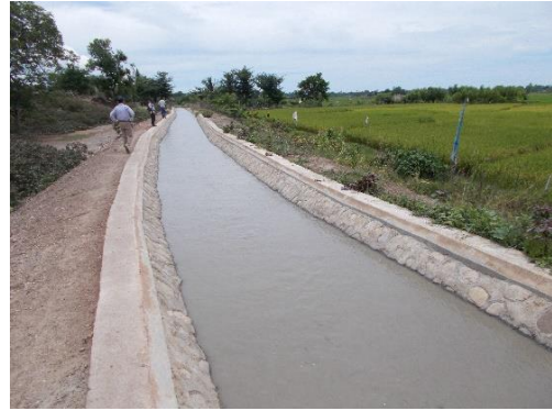
ブルト灌漑施設の支線水路 (雨期で水量が多い)
