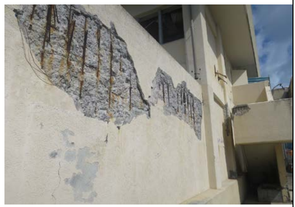
水産センター棟海側（西側）外壁：コンクリートの劣化・中性化により剥離やクラックが発生している。
