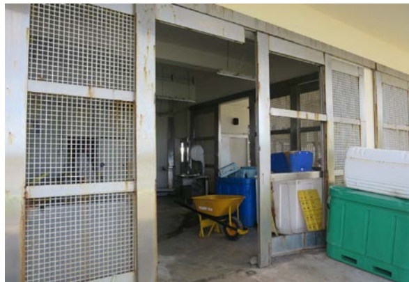
市場・管理棟1階：魚処理室の吊り扉が破壊されている。
