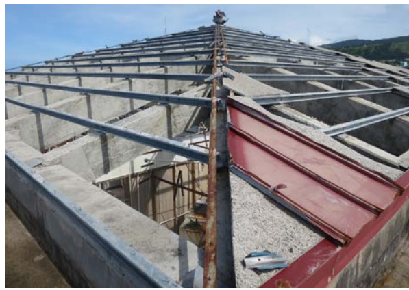
水産センター棟：屋根（ガルバリウム鋼板）が下地材とともに完全に吹き飛ばされている。
