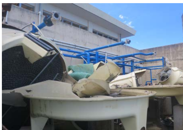
水産センター棟外構：外部設置の冷却塔は完全に破壊されている。
