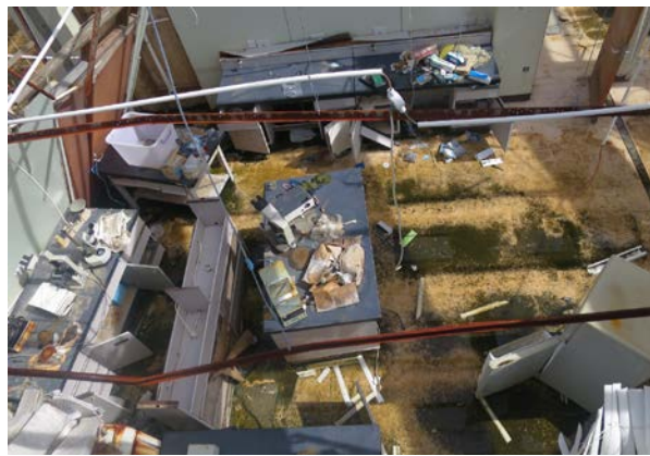
水産センター棟2階：屋根が飛んだため階下の水産局事務所の内装、建具は完全に破壊されている。
