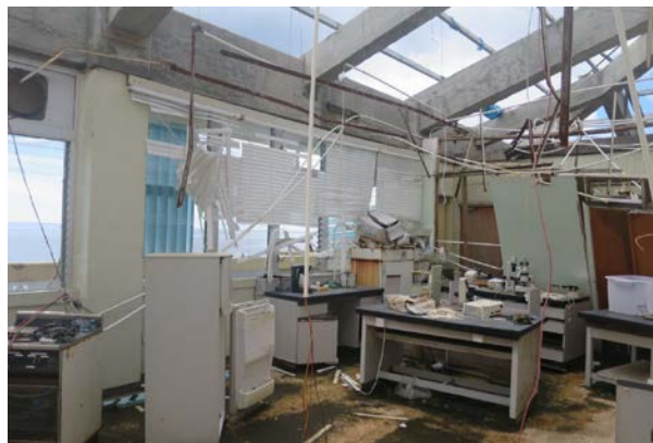
水産センター棟2階：屋根が飛び、窓等の開口部も完全に破壊されている。
