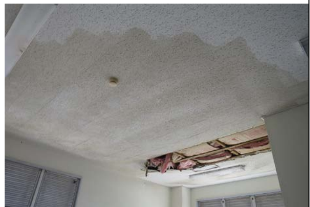
市場・管理棟：防水シートの剥離により、階下の天井は雨漏りで劣化している。
