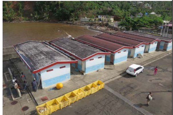
漁民ロッカー棟：屋根の防水シートが剥離している。
