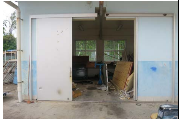
ワークショップ棟：ドアが破壊されている。
