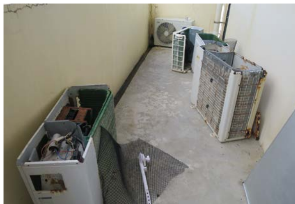
市場・管理棟2階：空調機（室外機）6台が完全に破壊されている。
