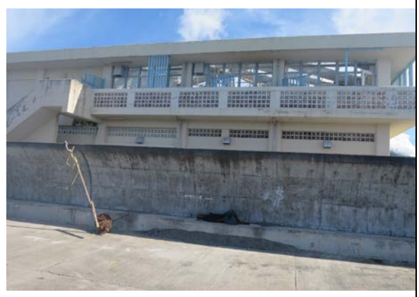
水産センター棟：海側（西側）には防潮堤が（GL+2.5m）が設置されているが、建物2階部のルーバーや窓が破壊されている。
