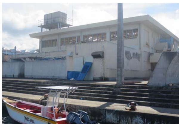
水産センター棟（北側）は防潮堤がないため2階窓が完全に破壊されている。
