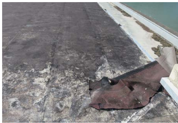
市場・管理棟：屋根防水シートが完全に剥離している。
