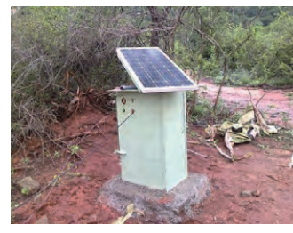
ソーラーパネルと配電盤
