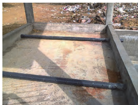
汚泥乾燥床の多孔パイプ
