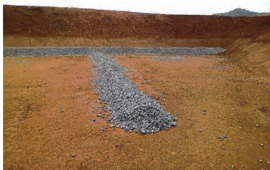
枝管 (碎石により覆われている)
