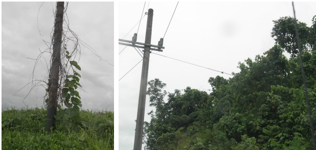
(a) 電柱の迂回ルートで生長 (b) 支線への巻きつき状況
