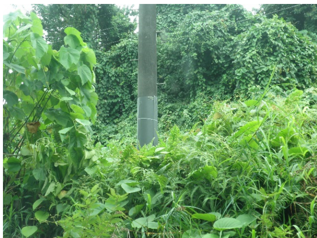
図 9-1-4-1.2 電柱付近のツタの状況
