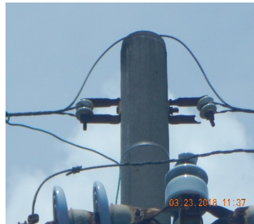
(b) がいし支持金物の腐食破断
