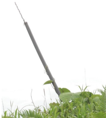
図 9-1-4-1.3 支線への巻きつき状況
