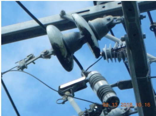
図 9-1-5-1.4 機材の破損（避雷器）
