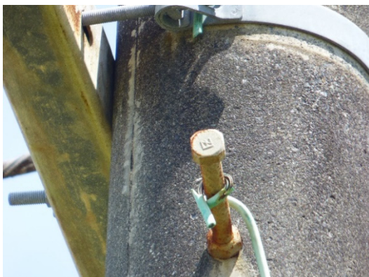
図 9-1-5-1.6 中性線の接地線断線
