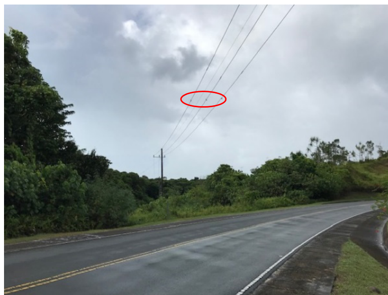
図9-1-4-1.11 過電流表示器の設置例（コクサイ変電所付近の線路）
