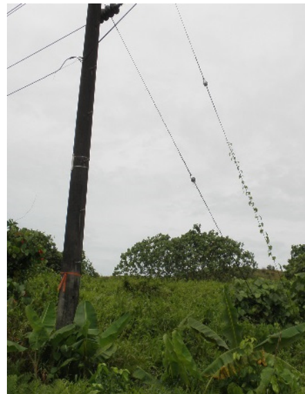
図 9-1-4-1.8 ツタガードの取り付けがない 支線での成長
