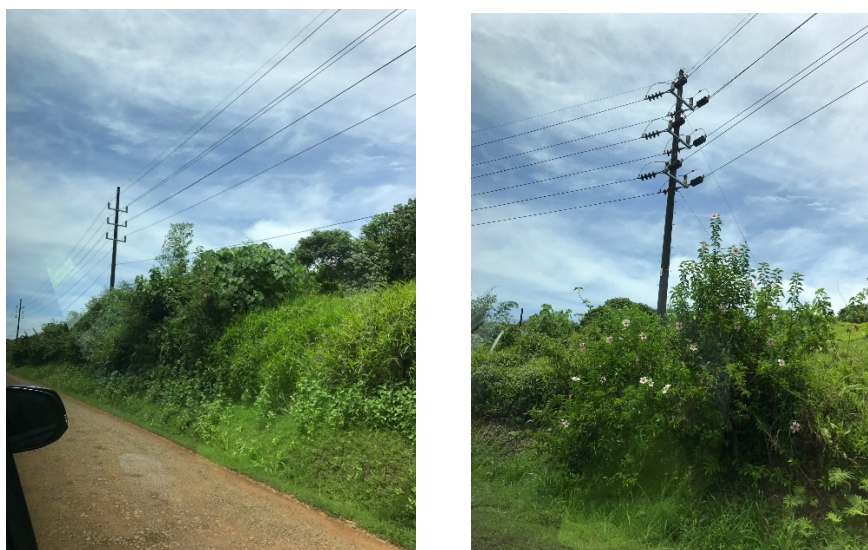
図 6-1-1-5.2 送電2回線併架区間（アイメリーク発電所～ネッケン変電所間）の装柱状況 (左：引通し柱、右：引留め柱)
