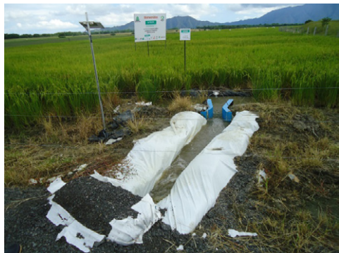
同左（流量計測施設）
