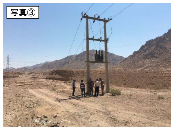
建設予定地には電力設備（高圧ケーブル）が 延伸・設置されている
