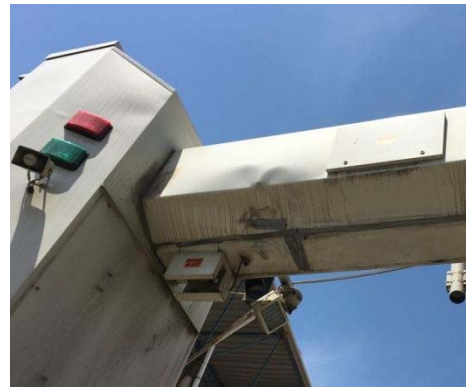
検査対象貨物の接触による破損
