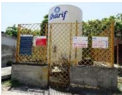
写真1 液化酸素 CE5 タンク
