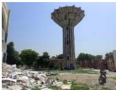
写真5 PIMS の高架水槽 OHWT1
