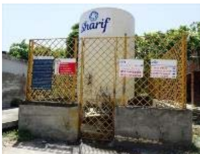
写真1 液化酸素 CE5 タンク
