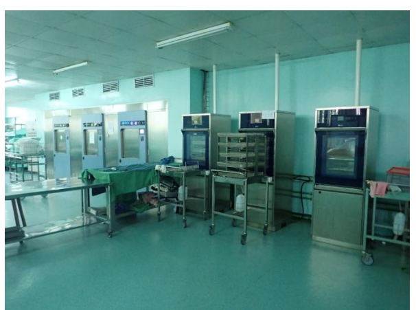
Salle de stérilisation du bâtiment principal Trois grands stérilisateurs sont mis en place.
