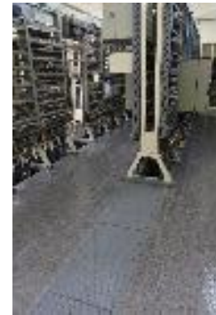
Figure 7.14 État du local des équipements de commande et de protection
