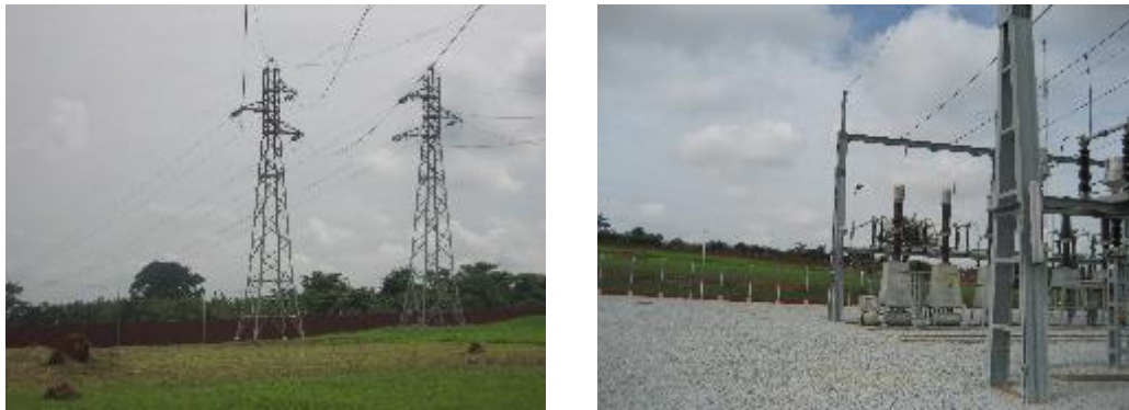
Figure 7.9 État des équipements du poste de Yamoussoukro1
