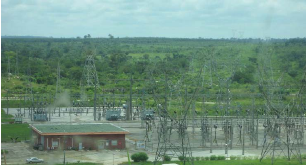
Figure 7.10 Vue d'ensemble du poste de Taabo
