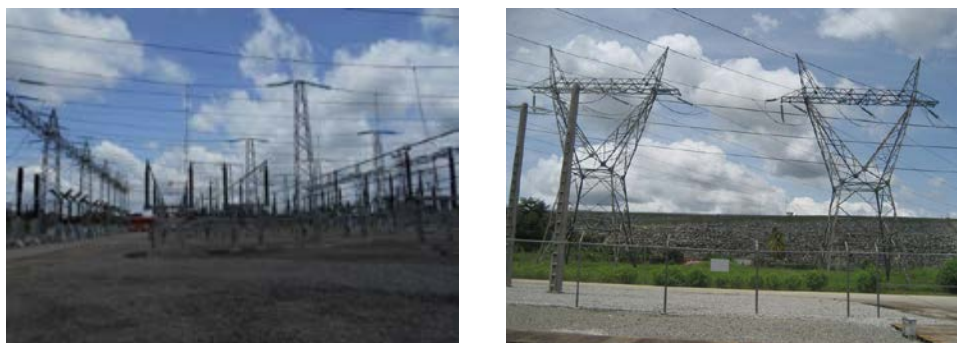
図 7.12 延長済の母線 (左) と開閉設備設置スペース (右)
