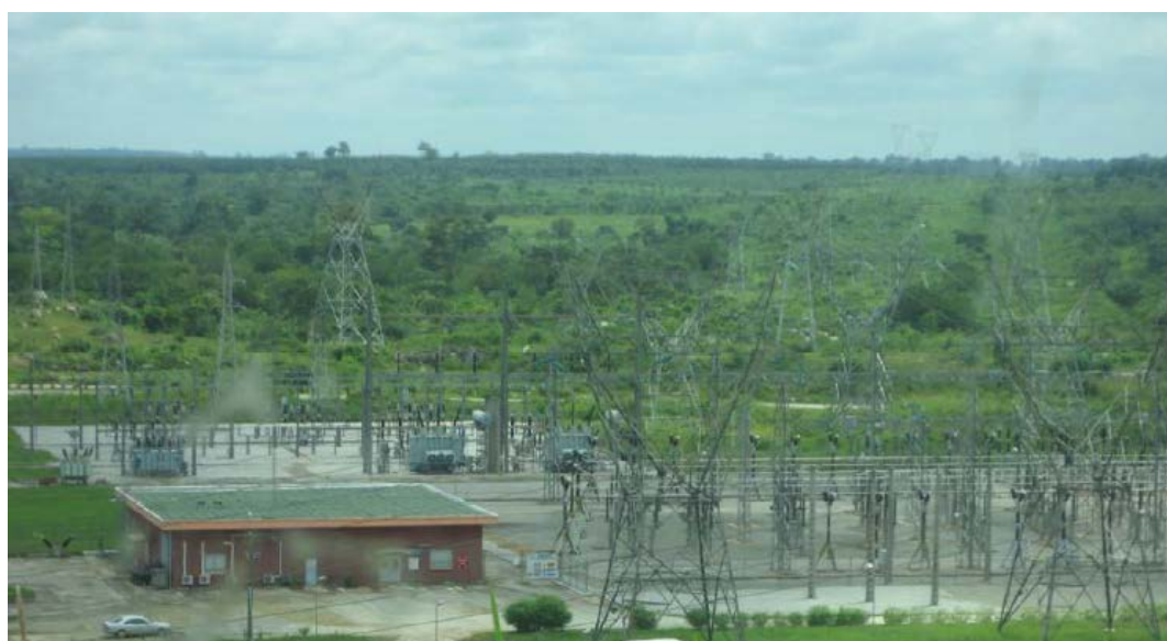
図 7.10 Taabo 変電所の全景
