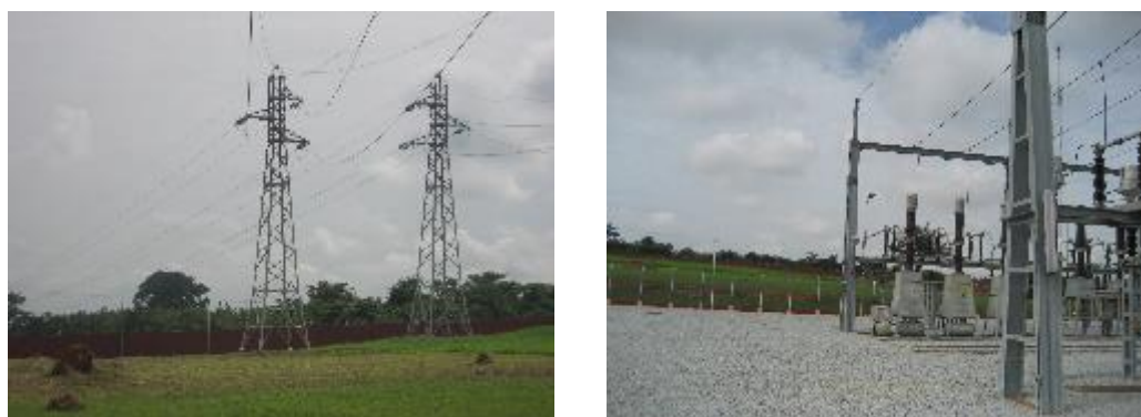
図 7.9 Yamoussoukro1 変電所の設備状況
