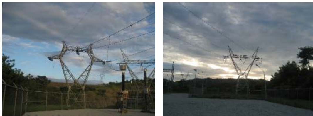
図 7.18 開閉設備設置スペース（左が Yamoussoukro2 方面、右が Taabo 方面）
