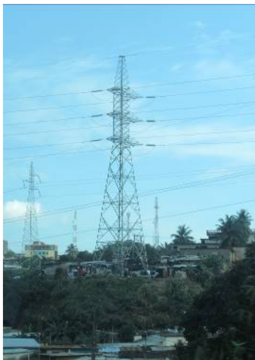
図 4.6 225kV 山形鉄塔 (四角鉄塔、2回線、耐張、Abidjan 周辺)
