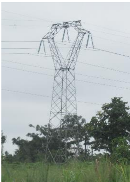
図 4.4 225kV 山形鉄塔 (烏帽子型、1 回線、懸垂、 Kossou・Bouake 間)
