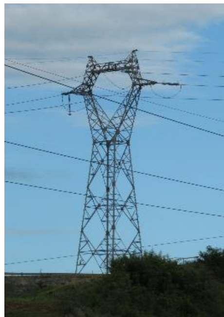
図 4.5 225kV 山形鉄塔 (烏帽子型、1 回線、耐張、Kossou 周辺)
