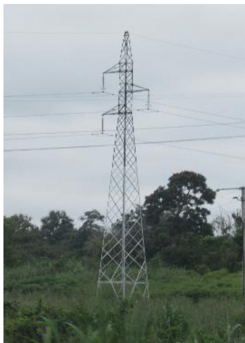
図 4.8 90kV 山形鉄塔 (四角鉄塔、1回線、懸垂、 Taabo-Kossou 間)
