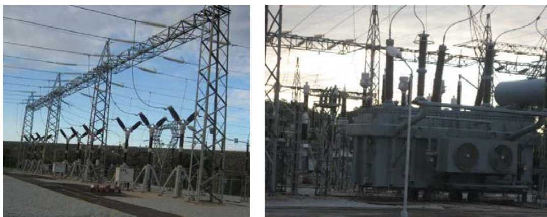
図 4.21 225kV 変電設備
