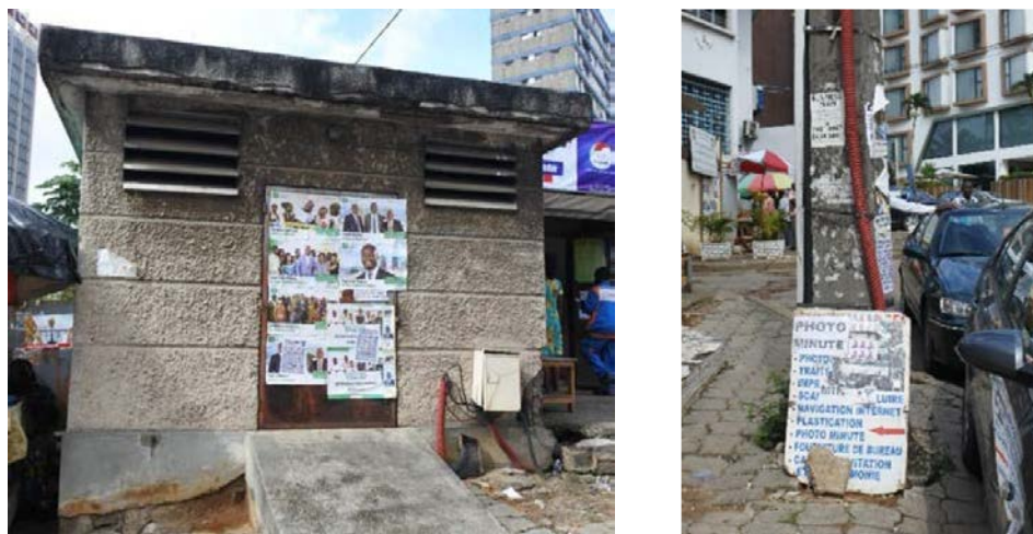
図 4.22 配電設備収納建屋と電柱への配電線の立上げ状況
