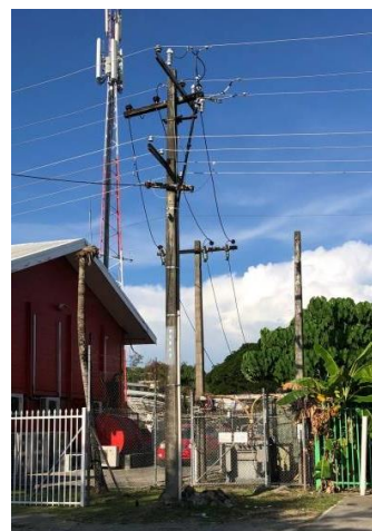
写真 2-13 都市部の変圧器
