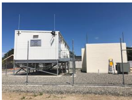
写真 2-7 ラナディ変電所
