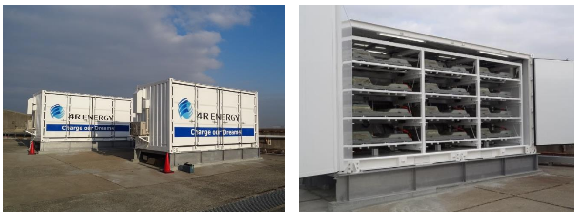
写真 4-1 ユースバッテリー：（左） 外観、（右） 内側に配置されたバッテリーパック
