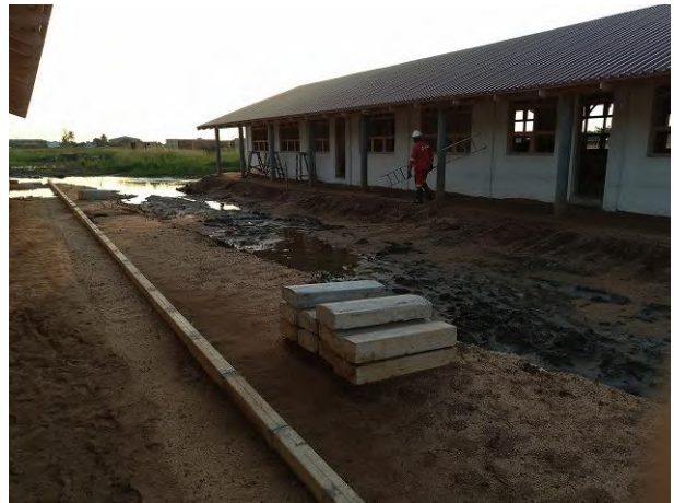
写真12: 建設中の新 Quelimane 中学校。工事は大幅に遅延しており完成の目途は立っていない。
