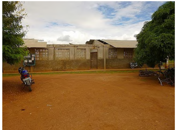
写真 4: 突風で破損した建物。中央の教室は使用不可、右手の教室では屋根に穴が開いたまま授業が行われている。左側管理諸室も一部のみ使用可で教員は屋外で授業準備等を行っている。
